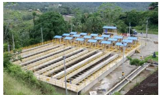
Planta de Tratamiento de Agua Potable Venecia Buenaventura, Valle del Cauca
