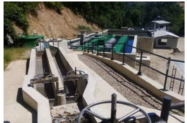
Planta de Tratamiento de Aguas Residuales y Ocaña, Santander
