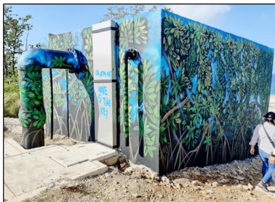
Caseta de equipos de bombeo de captación por toma directa de agua de mar.
