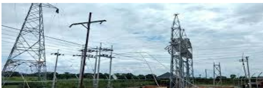
Ilustración No. 47: Subestación Tibú- César
