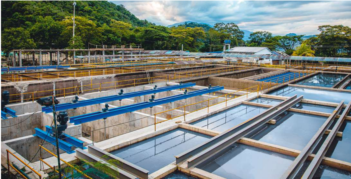
La optimización de la Planta de Tratamiento de Agua Potable de La Esmeralda, ubicada en Villavicencio (Meta) ha contando con la supervisión de Findeter.
