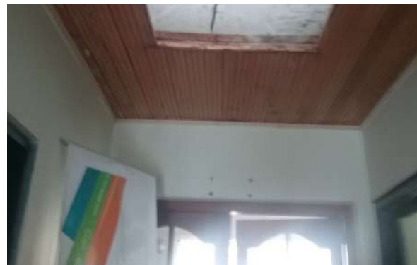
Ilustración 267. Elementos no estructurales en mal estado Fuente. Equipo de diagnóstico
