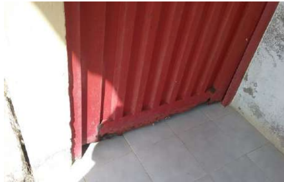
Ilustración 165. Elementos no estructurales en mal estado Fuente. Equipo de diagnóstico
