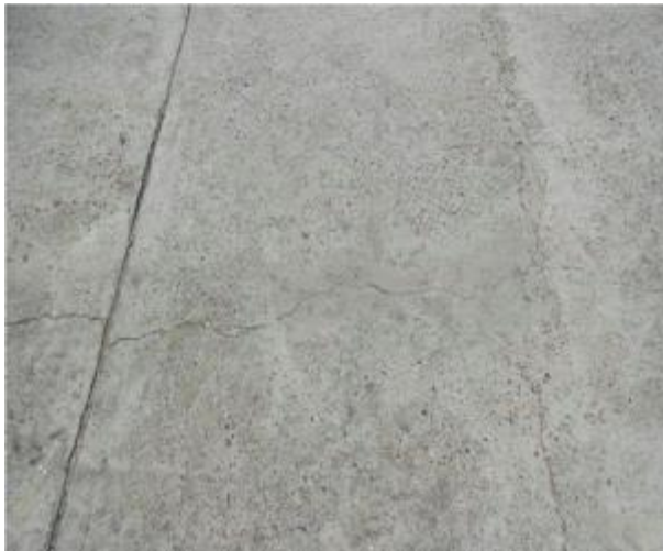
Detalle Fisuras 3m por 5cm de profundidad Placa cancha
