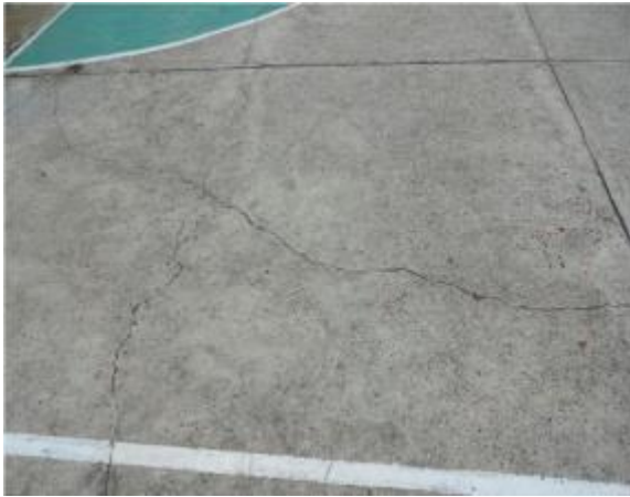
Detalle Fisuras 3m por 5cm de profundidad Placa cancha
