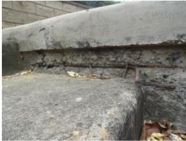
Detalle acero expuesto
