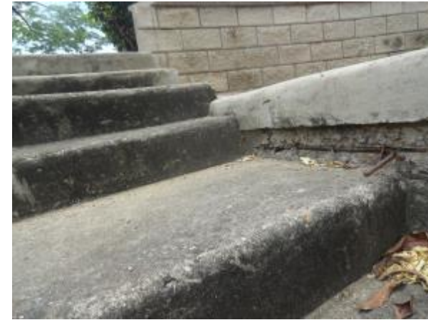
Detalle acero expuesto
