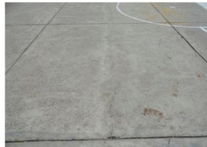
Detalle Fisuras 3m por 5cm de profundidad Placa cancha
