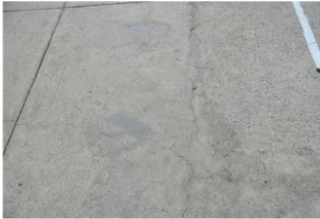
Detalle Fisuras 3m por 5cm de profundidad Placa cancha
