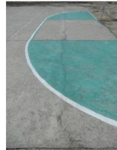
Detalle Fisuras 3m por 5cm de profundidad Placa cancha
