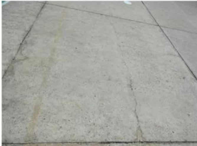
Detalle Fisuras 3m por 5cm de profundidad Placa cancha
