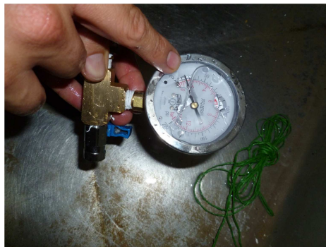
Figura 3. Toma de presión en la cocina (20 psi)
