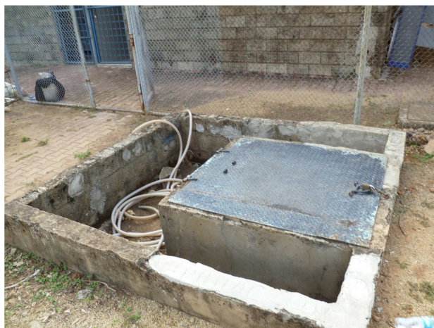
Figura 5. Tapa de acceso tanque bajo de agua potable frente a la PTAP
