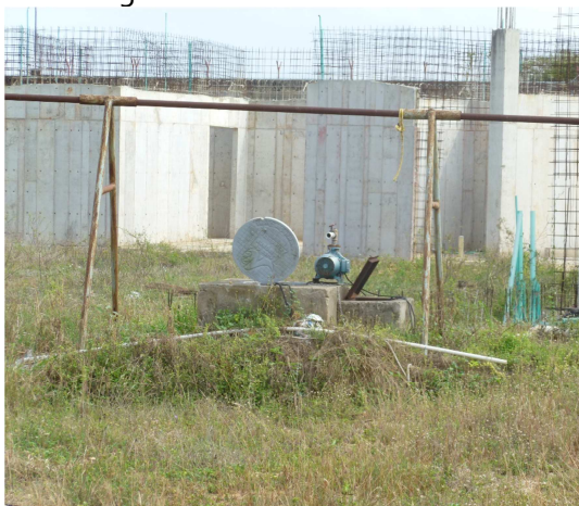
Figura 6. Pozo séptico y bomba para evacuar A.R.
