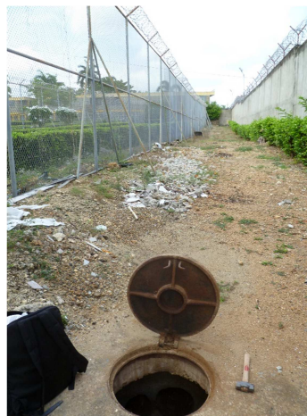
Figura 7. Pozo de aguas lluvias
