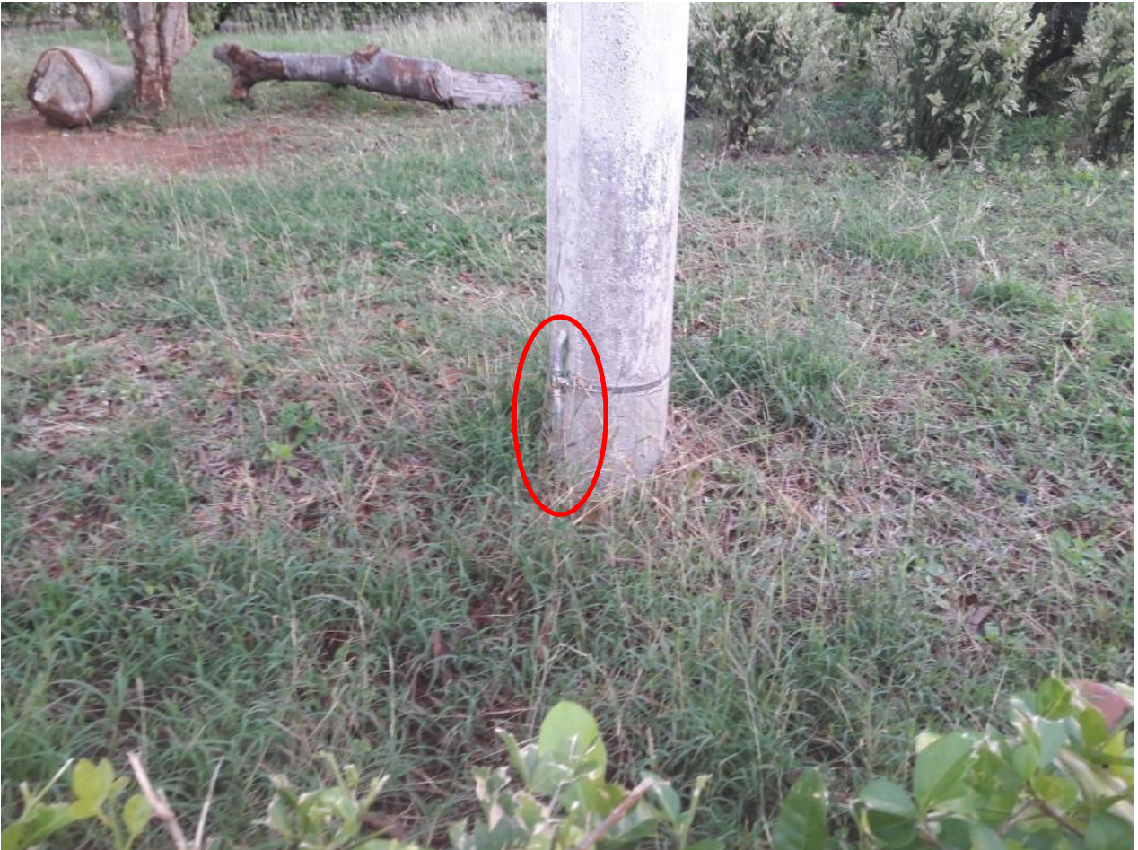
FOTO N° 9 TUBERÍA A LA VISTA TIPO EMT NO APTA PARA ESTE USO
