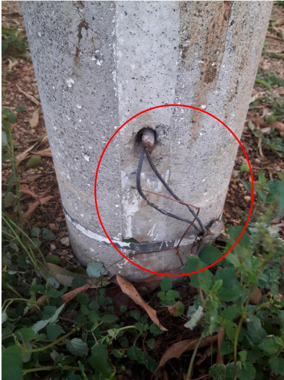
FOTO N. 8 MALAS CONEXIONES EN LOS POSTES POR DETERIORO
