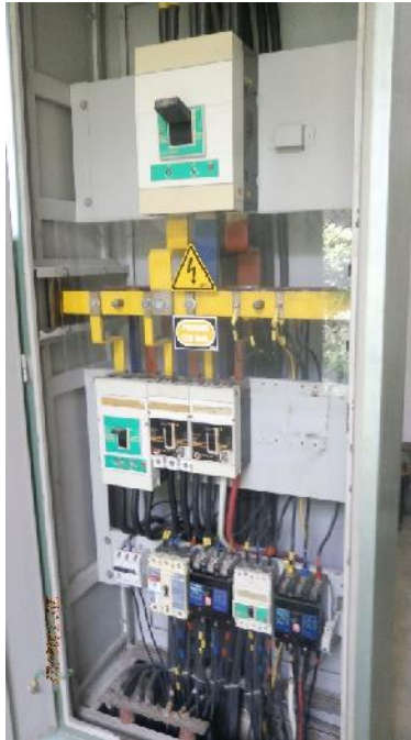
FOTO N.3 TABLERO GENERAL DE DISTRIBUCIÓN
