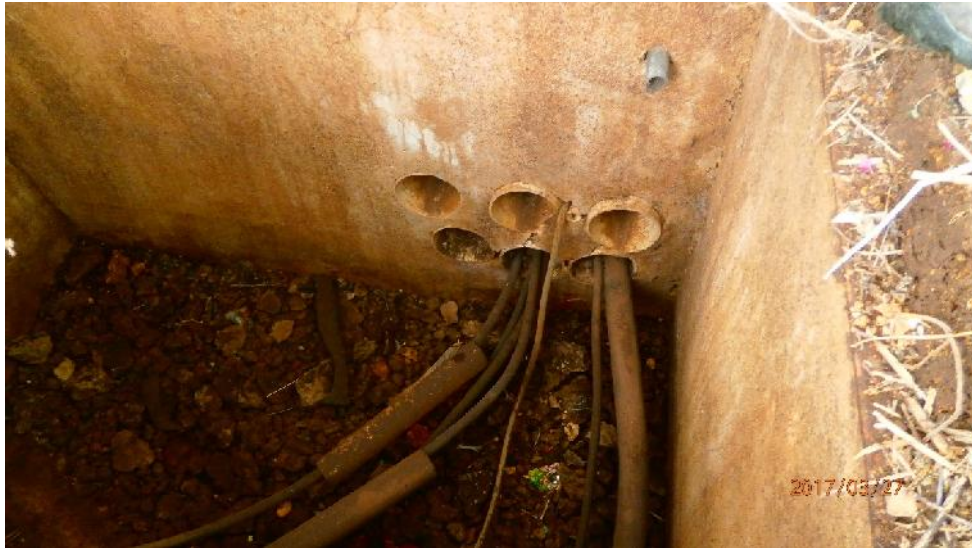
FOTO N.4 CAJAS Y DUCTOS DE DISTRIBUCIÓN
