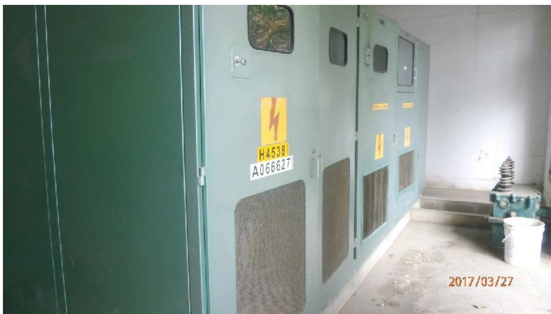
FOTO N.1 SUBESTACIÓN ELÉCTRICA CAE TURBACO
