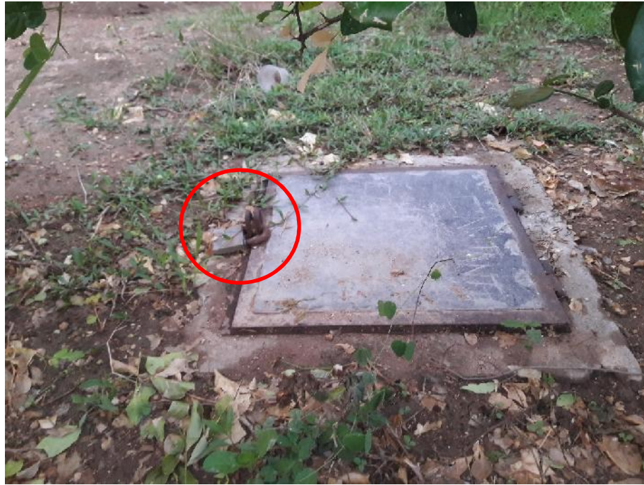
FOTO N° 10 CAJA DE DISTRIBUCIÓN CON CANDADO EN MAL ESTADO
