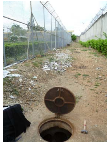
Figura 7. Pozo de aguas lluvias
