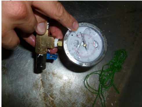
Figura 3. Toma de presión en la cocina (20 psi)
