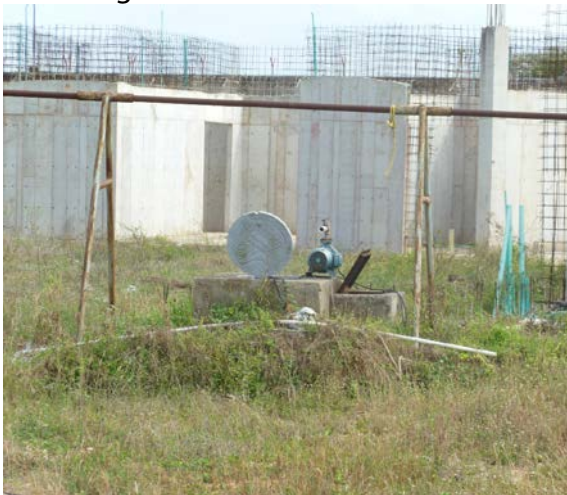
Figura 6. Pozo séptico y bomba para evacuar A.R.
