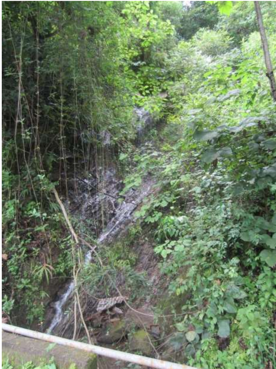
Fotografía 5. Agua de escorrentía sobre talud de la margen izquierda de la vía, en sentido Labranzagrande – Yopal
