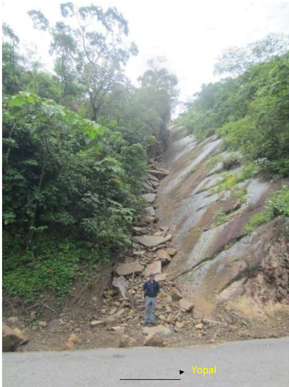
Fotografía 6. Sitio inestable 4: Flujo de detritos del talud de la margen izquierda en sentido Labranzagrande - Yopal
