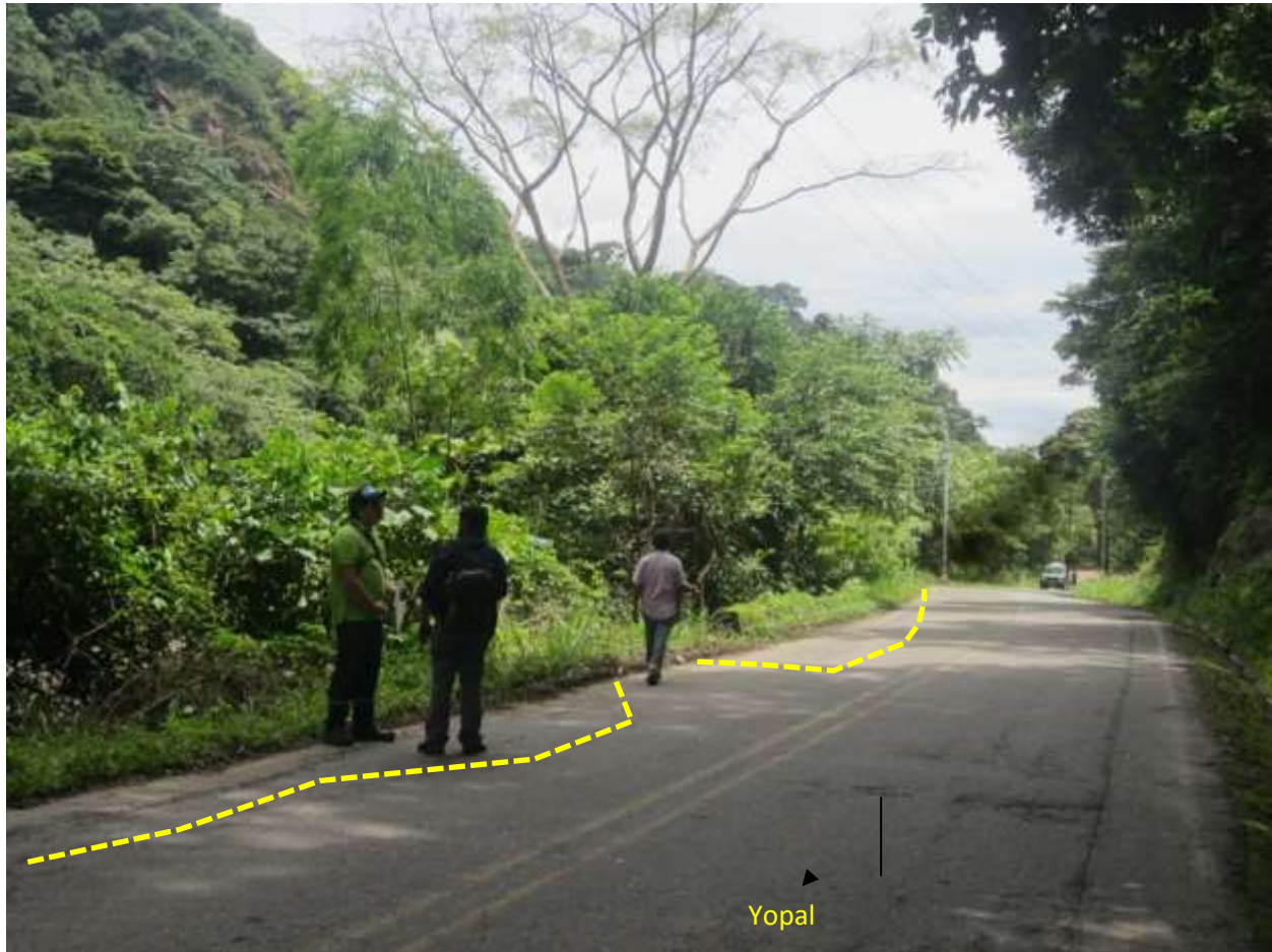
Fotografía 7. Sitio inestable 5: Hundimiento de la vía sobre la margen derecha en sentido Labranzagrande – Yopal. Fallas del pavimento en media luna
