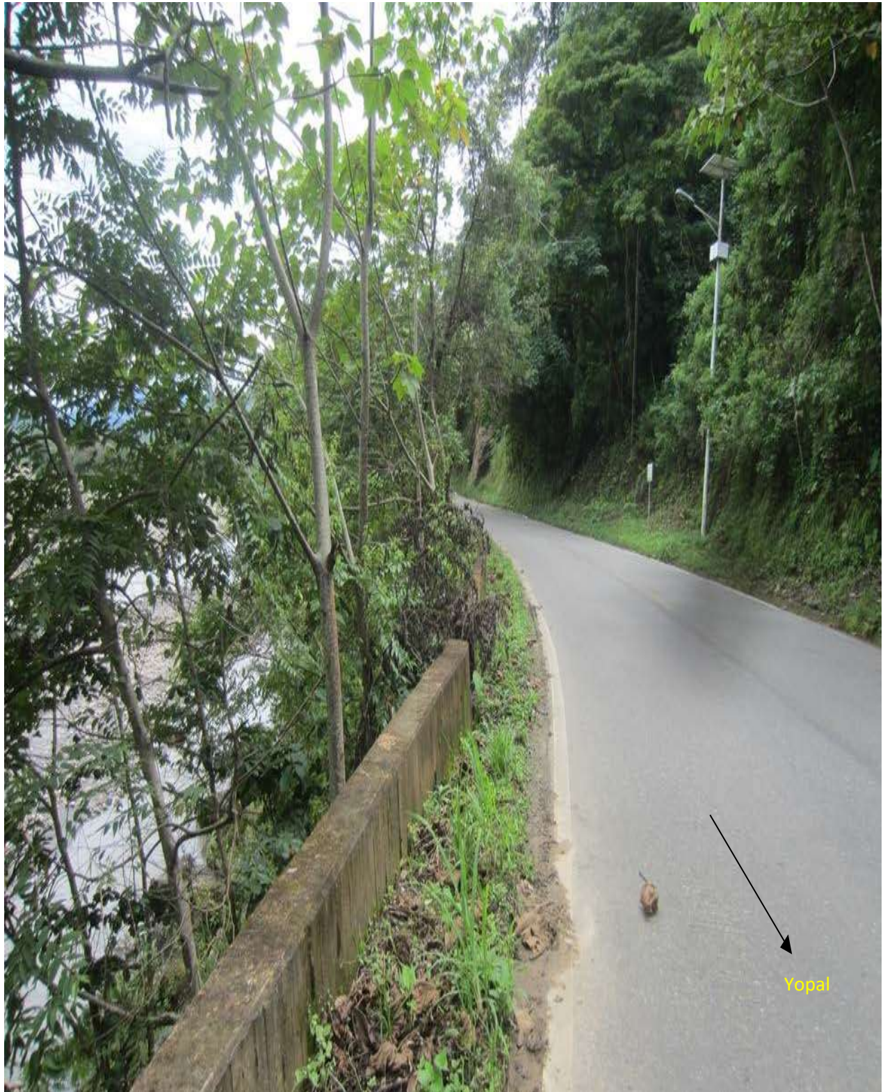
Fotografía 4. Sitio 3: Socavación lateral sobre la margen derecha de la vía, muros de contención expuestos a socavación
