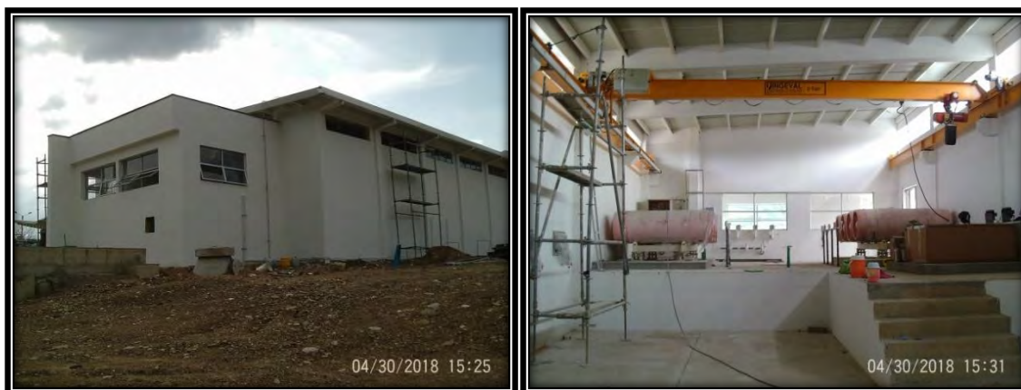
Fotografía No. 13 Avance de ejecución Edificio de cloración (Panorámica de estado actual de avance, estuco sobre muros interiores).
