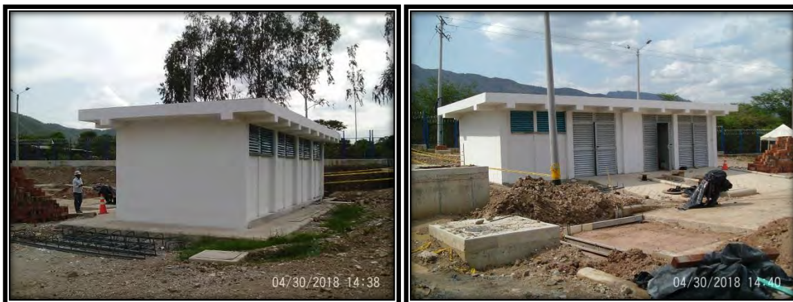
Fotografía No. 7 Avance de ejecución Edificio Sub Estación Eléctrica (Panorámicas de estado de avance)
