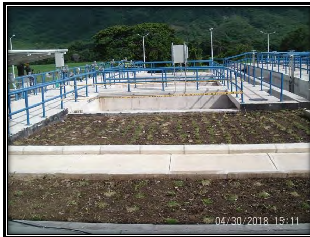
Fotografía No. 14 Avance de ejecución de Andenes (Panorámica de andenes adyacentes al edificio administrativo).
