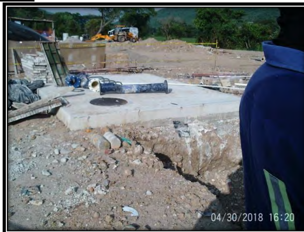
Fotografía No. 17 Avance de ejecución caja macromedidores (Armado de acero de refuerzo y encofrado de muros de caja de macromedidor de 20")
