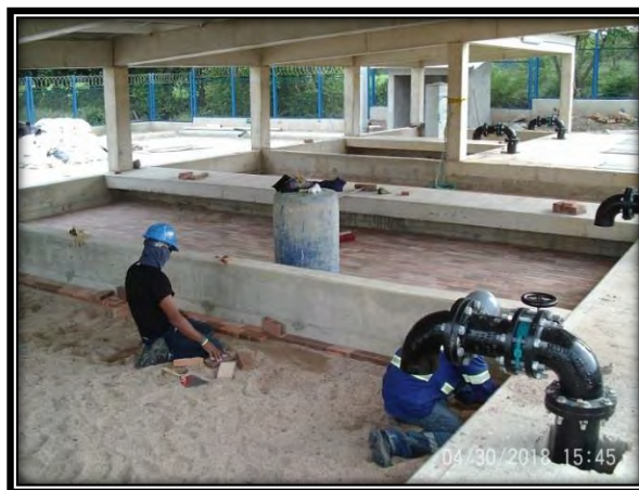
Fotografía No. 2 Avance de ejecución Lecho de Secado de Lodos (Panorámica actual de avance).
