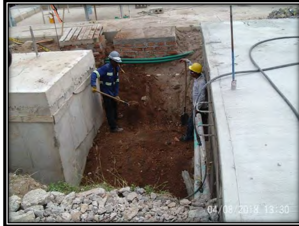
Fotografía No. 16 Avance de ejecución interconexión (Panorámica de rellenos entre caja de interconexión y empalme con PTAP existente)
