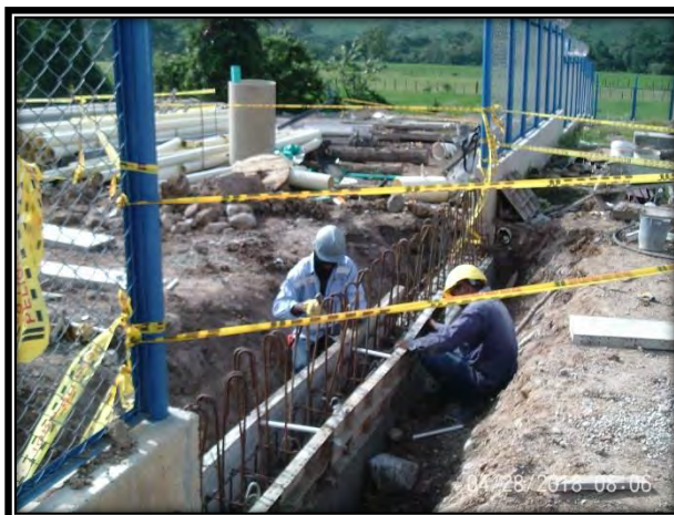
Fotografía No. 8 Avance de ejecución cerramiento definitivo (Panorámica de estado de avance del cerramiento en costado sur este de la PTAP).
