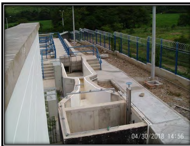
Fotografía No. 12 Avance de ejecución Canaleta Parshall (Panorámica de estado de avance).
